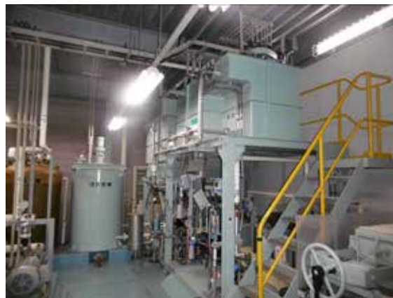
排水処理設備
