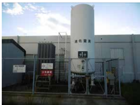
一般高圧ガス製造施設設備
