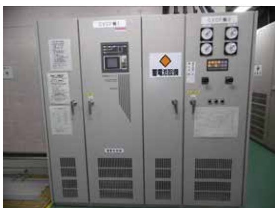
無停電電源装置設備
