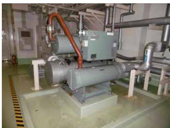
冷水・冷却水設備
