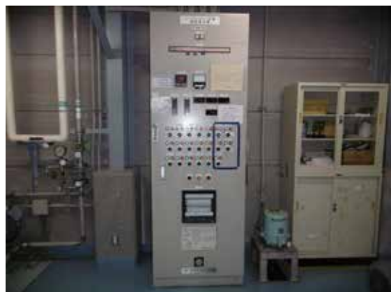
ユーティリティ排水設備
