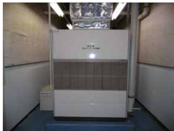
換気空調設備
