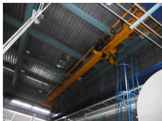
ホイスト式天井クレーン設備
